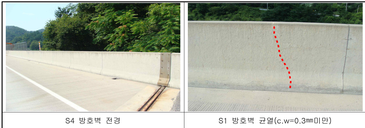
【사진 3.12】 방호벽 손상 현황
