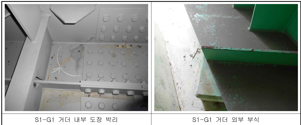
【사진 3.2】 거더 손상현황(계속)
